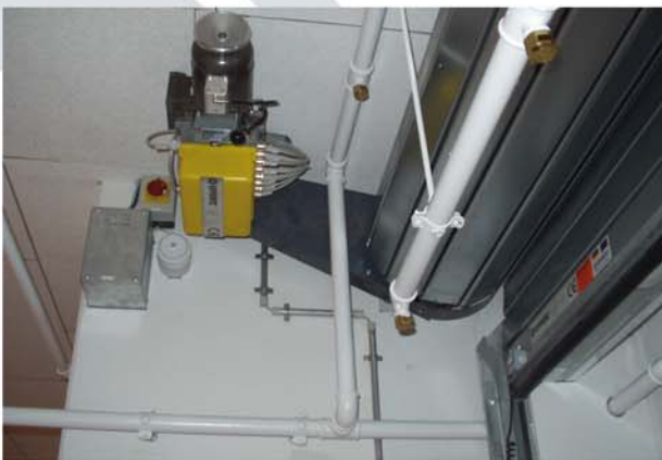
Tor mit Sprinklerleitung
